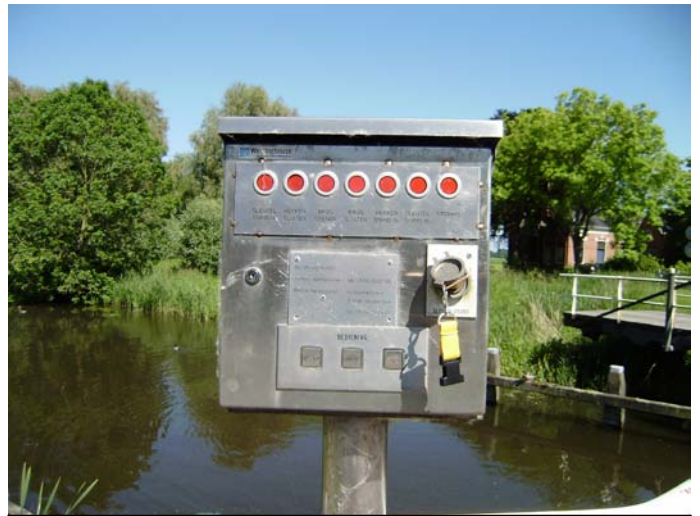
De brug bedieningskast, met de Oostgroningensleutel
